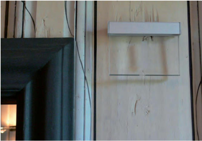
Nur im Brandfall leuchtendes Rettungszeichen
