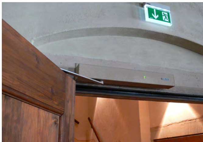
Obertürschließer in Bestandstür
