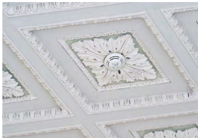
Integrierter Rauchmelder (Detailansicht)
