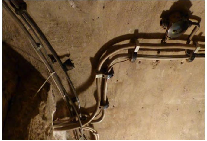
Elektroleitungen als Brandentstehungsrisiko und Gefahrenquelle einer möglichen Brandweiterleitung
