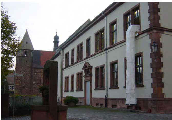
Personenrettungsschlauch als zweiter Rettungsweg
