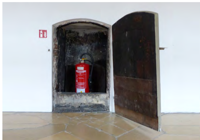
Nutzung einer Kaminanlage zur Unterbringung eines Handfeuerlöschers
